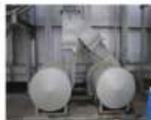
Seal air Fan
